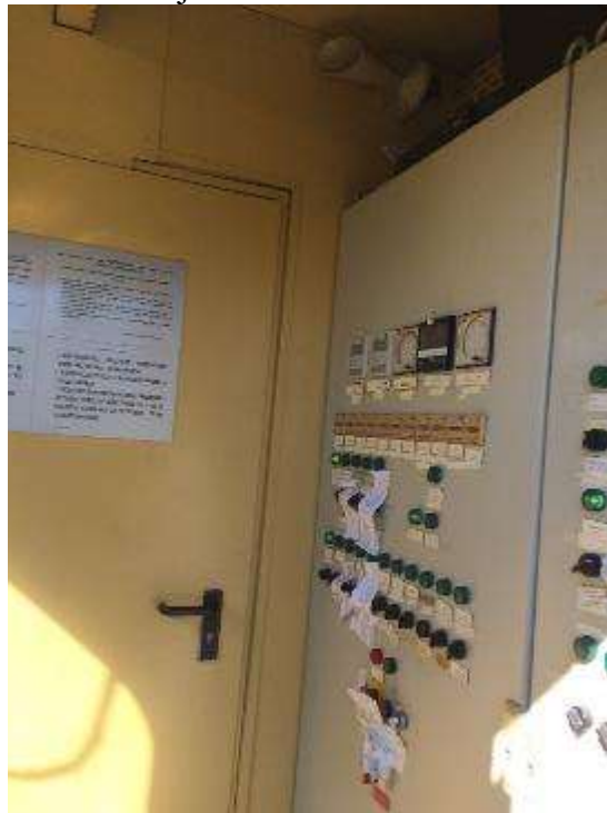
Kontrolna ploča u upravljačkoj postaji
