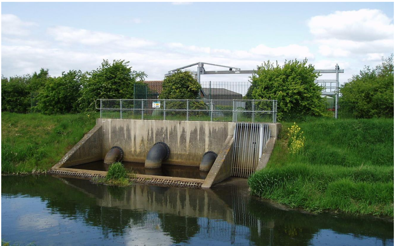
Slika 2.53 Primjer crpne stanice
