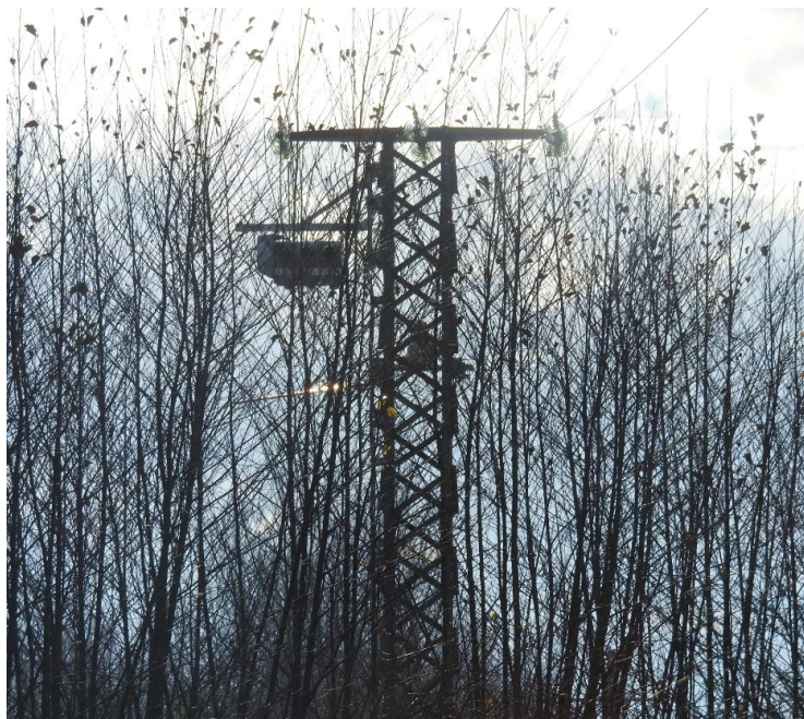
Fotografija 4-14: Transformator na području II. zone sanitarne zaštite (oznaka: L19)
