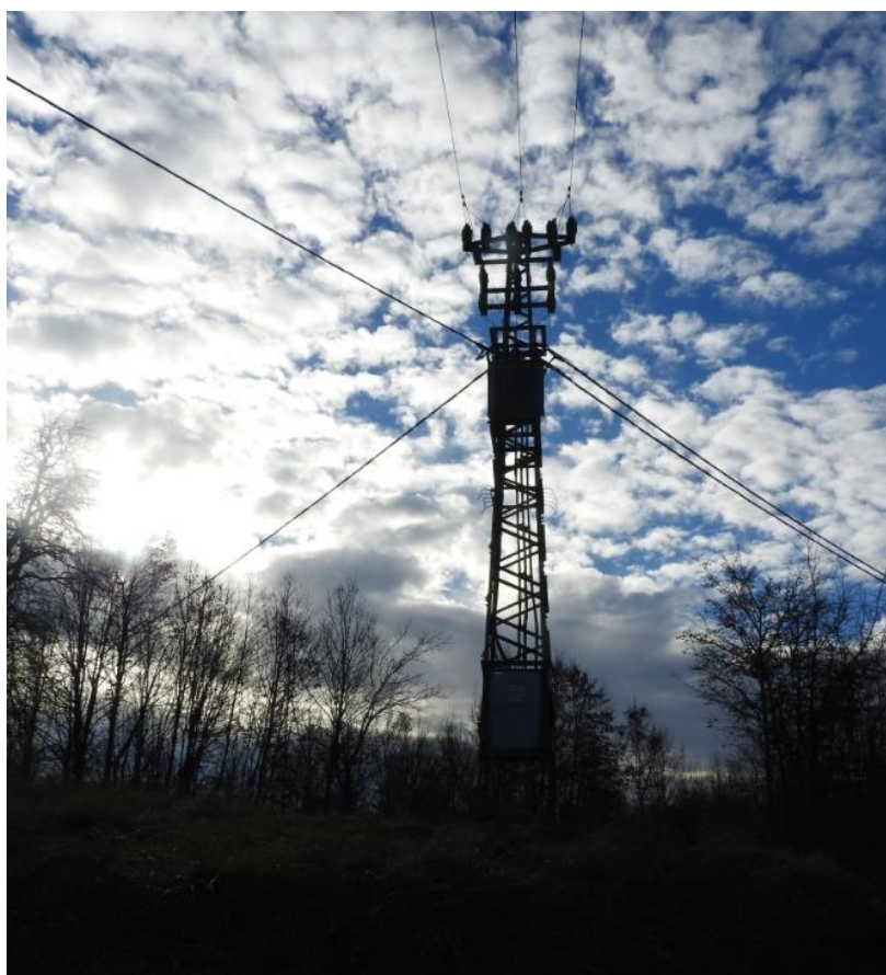
Fotografija 4-9: Transformator na području III. zone sanitarne zaštite (oznaka: L11)
