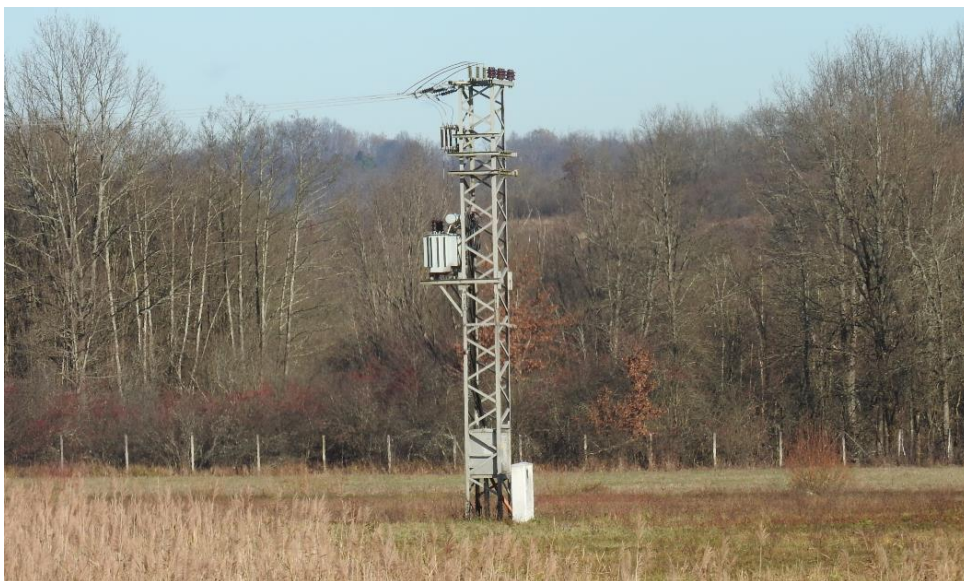
Fotografija 4-15: Transformator na području I. zone sanitarne zaštite (oznaka: L20)
