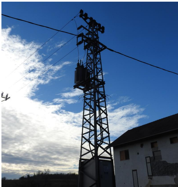
Fotografija 4-11: Transformator na području III. zone sanitarne zaštite (oznaka: L14)
