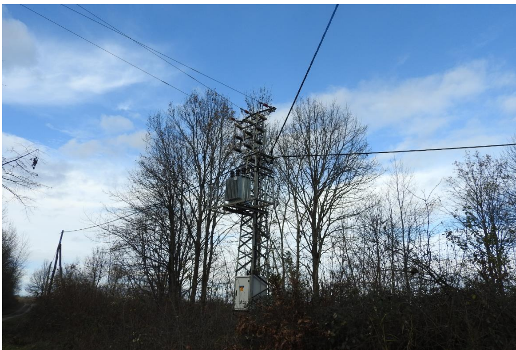
Fotografija 4-8: Transformator na području IV. zone sanitarne zaštite (oznaka: L9)
