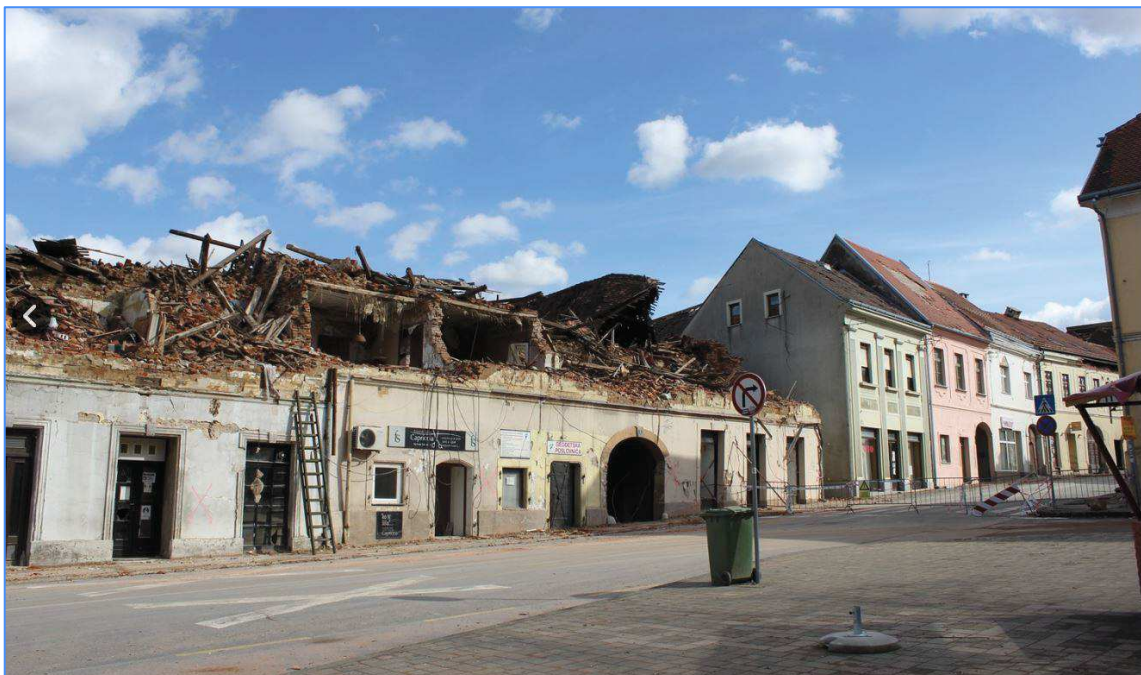
Slika 89. Oštećene zgrade u potresu unutar kulturno povijesne cjeline grada Petrinje Izvor: Program cjelovite obnove kulturno-povijesne cjeline grada Petrinje nakon potresa 2020.
