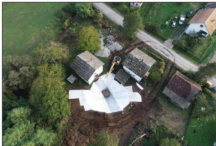
Slika 80. Sanacija urušene vrtače u Mečenčanima tijekom 2021. i 2022. zatrpavanjem različitim frakcijama materijala 143 Izvor: Stožer civilne zaštite
