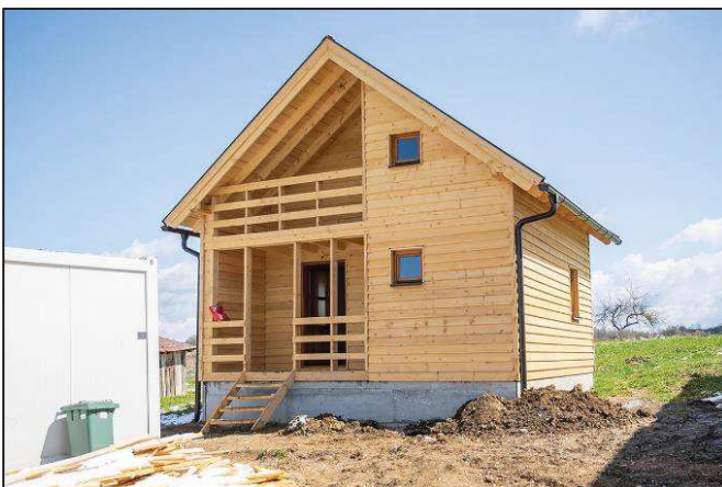
Slika 99. Izgrađena obiteljska kuća u selu Donja Bačuga, Grad Petrinja, „Kuća nade“, zajednički projekt Udruga „Bauern helfen Bauern“ i Malteser Hrvatska, Caritas Sisačke biskupije, Grada Petrinje i Fondacije „Kuća dobrih tonova“ Izvor: https://ika.hkm.hr/novosti/na-banovini-predstavljen-projekt-kuca-nade/
